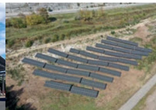
Centrale photovoltaïque implantée au sol
