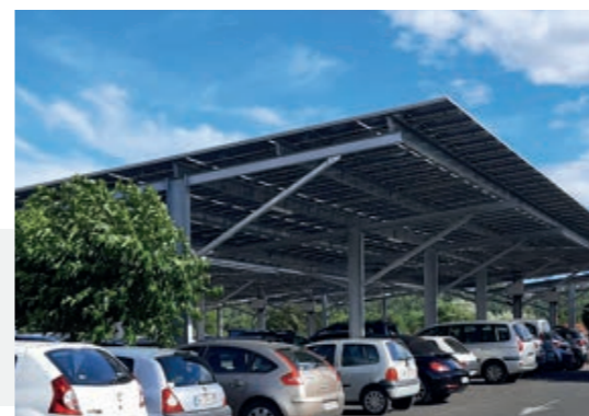
Ombrières photovoltaïques couplées à des bornes de recharge
